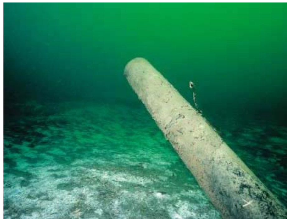
Udløbsledning fra renseanlæg og industri, Køge Bugt, foto Roskilde Amt.
